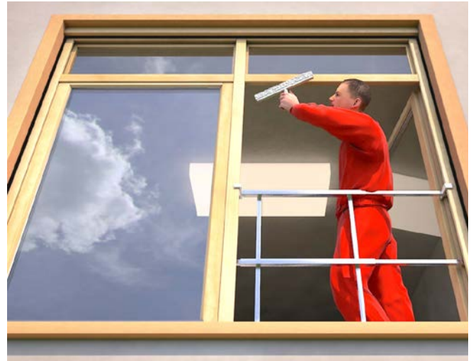
Abb. 3 Mobiles Schutzgeländer in Fensterrahmen
