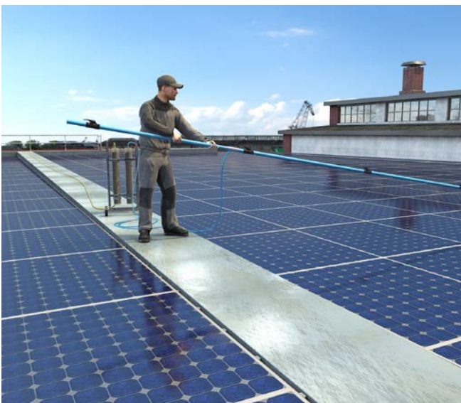
Abb. 16 Reinigung von Photovoltaikanlagen mit entmineralisiertem Wasser
